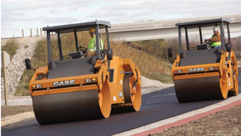
Figura: 10 Compactador de vibración
