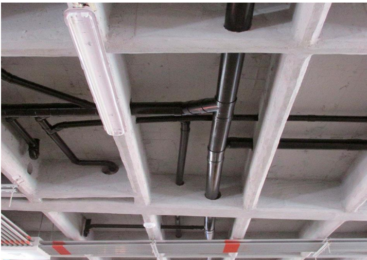
Figura 45: Tubería atravesando la vigueta
